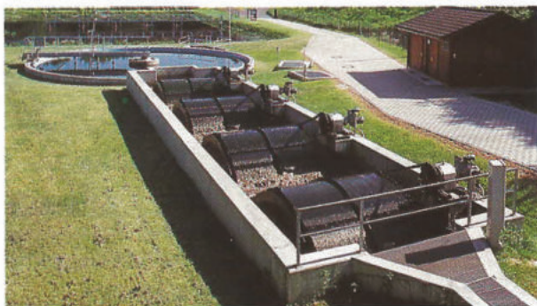
KA Nieder- / Oberzeuzheim - Baujahr 1989
