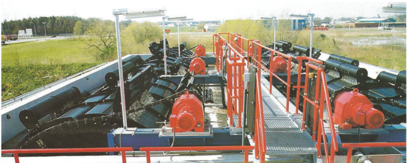
KA Hengelo Biologische Deponiesickerwasserbehandlungsanlage KA Hengelo, Niederlande Baujahr 1997 Ausrüstung: 6 Stück Zellrad ZR 8 x 5 + 8 Aufsatzröhren
