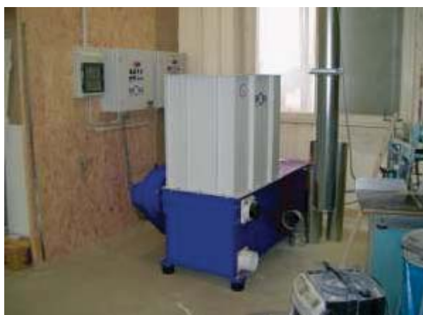
GAZ 62 Installation an eine Absaugung
