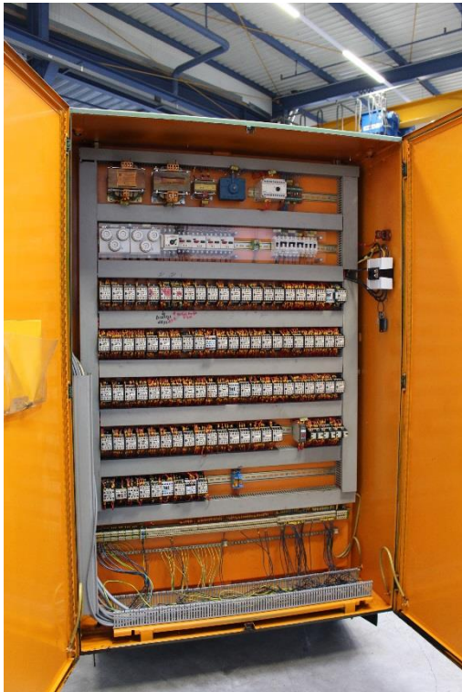
Elektro Schaltschrank an der Hydraulik befestigt
